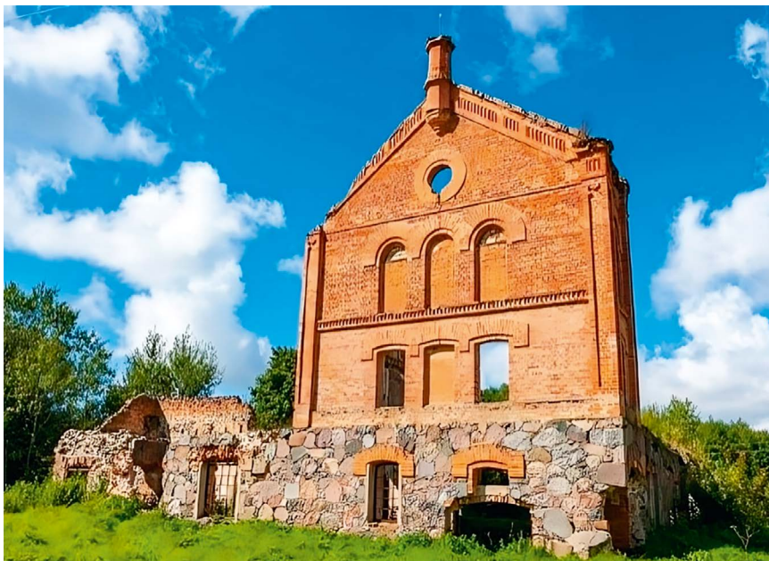
Рисунок 10. Руины здания бровара в усадьбе Скимунтов в Шеметово
